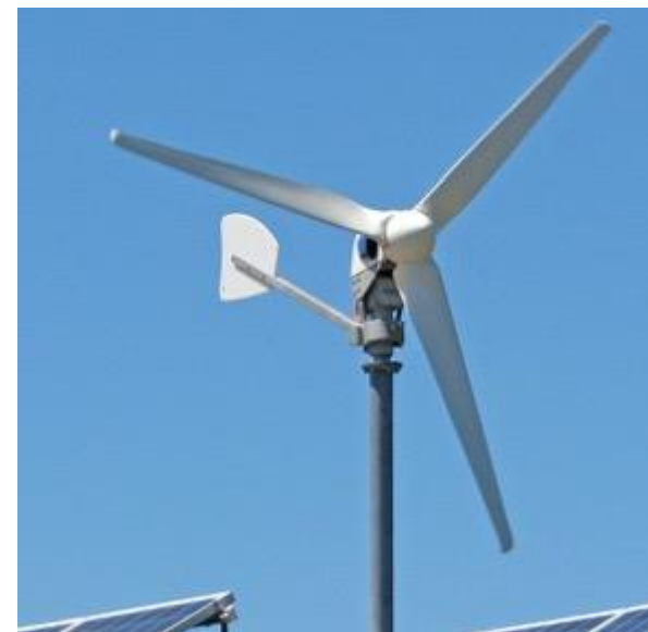
Slika: Primer vetrne elektrarne 3,5 kW za samooskrbo
