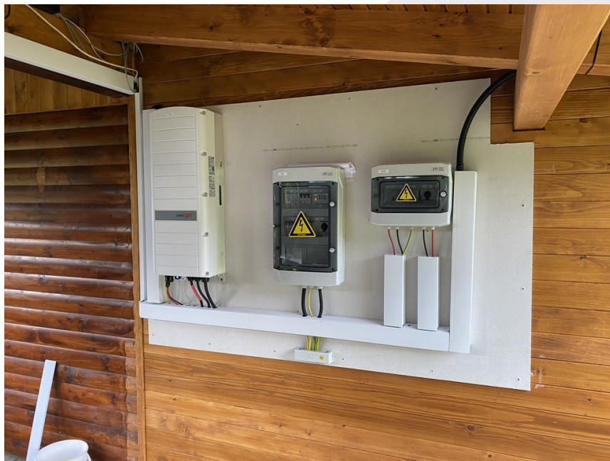
Inverter Solar Edge - RWS
